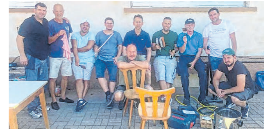
Die Alten Herren packen gern mal mit an, wenn es drum geht, was auf Vordermann zu bringen. Hier ein Bild nach dem Arbeitseinsatz an der Umkleide und Dusche. BILD: TSG EINTRACHT
